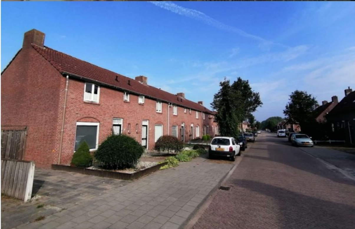
Boven: Kopgevel van een woning binnen het plangebied. Geen spouwopeningen, wel openingen onder de kantpannen.
