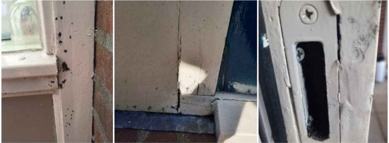
(1 en 2) Slecht verwerk en (3) provisorisch 'gerepareerd' sluitwerk
