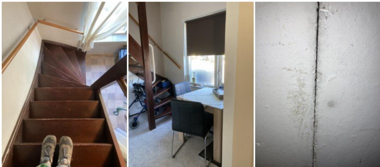
(1) Smalle trap met onhandige draai. (2) Eettafel in de bijruimte (naast voordeur), omdat in de woonkamer geen plek is. (3) Naden tussen plafondplaten.
