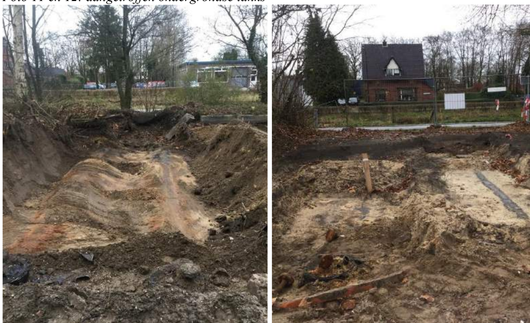
Foto 11 en 12: aangetroffen ondergrondse tanks
