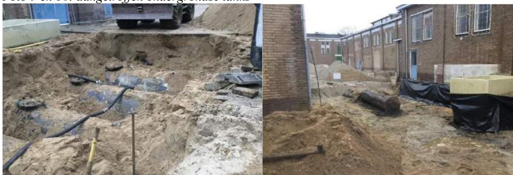
Foto 9 en 10: aangetroffen ondergrondse tanks
